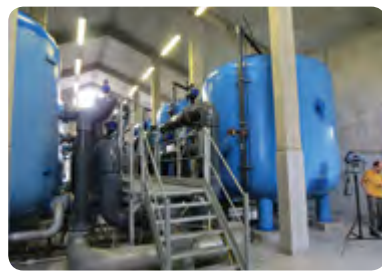
Črpališče Brestovica na Krasu (Projekt Hidrokarst).
