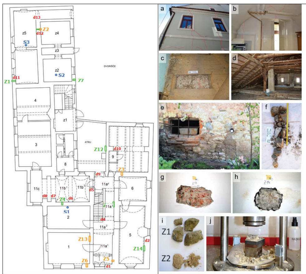
Slika 8. Tloris pritličja glavne in zadnje stavbe sodišča v Sevnici z lokacijami preglednih mest (levo), pregled poškodb (a, b), pregled stropa in strehe (c, d), globinsko sondiranje v kamnitem zidovju (e, f), površinsko sondiranje (g, h), odvzeti kosi malte (i) in laboratorijski preskus vzorca malte (j).
