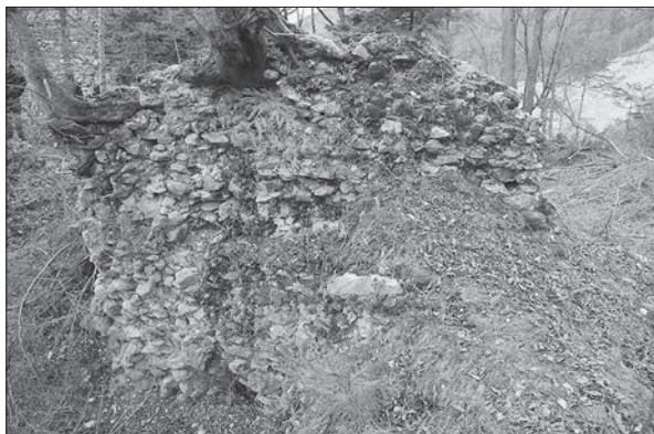
Ostanki spodnjega dela zunanje fasade nekdanjega jugovzhodnega trakta severovzhodnega dela kompleksa gradu Rudenek (foto: Igor Sapač, 2024).
