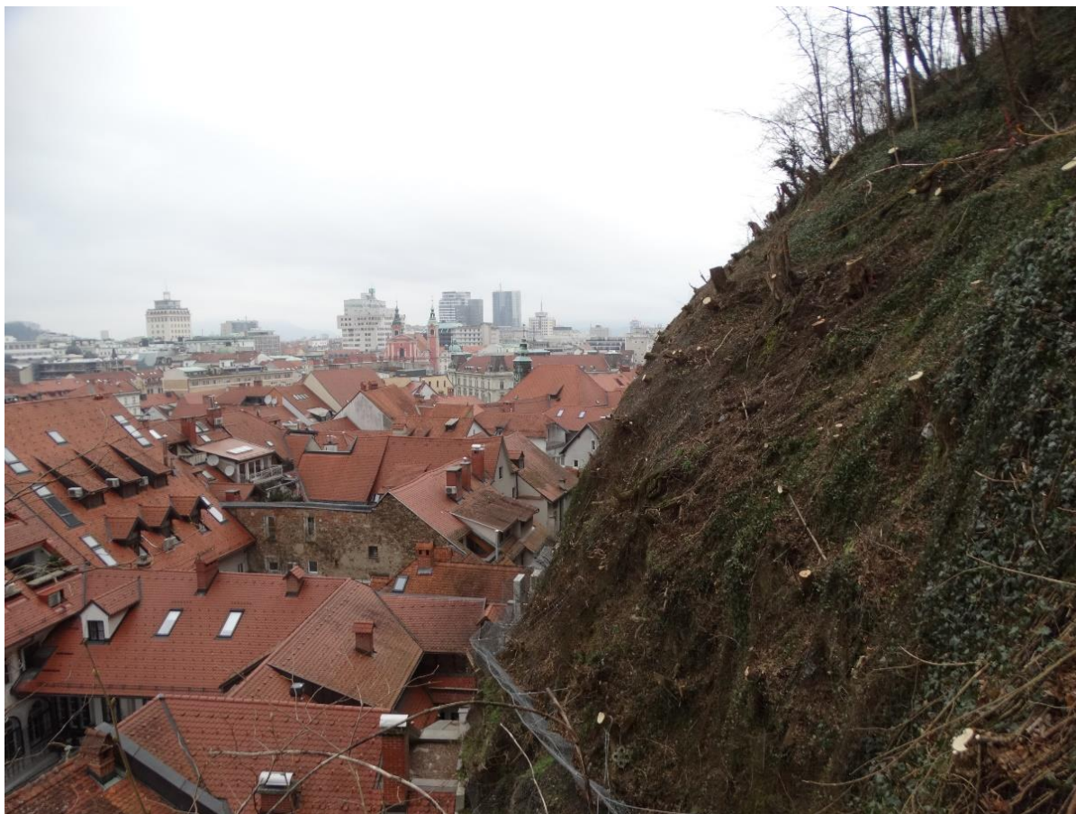
Slika 52: Preko celotnega pobočja je razpeta stara žičnata površinska mreža, ki se je popolnoma zlila s pobočjem Grajskega griča v Ljubljani. Na spodnjem delu je začasna lovilna ograja (Saražin J.)
