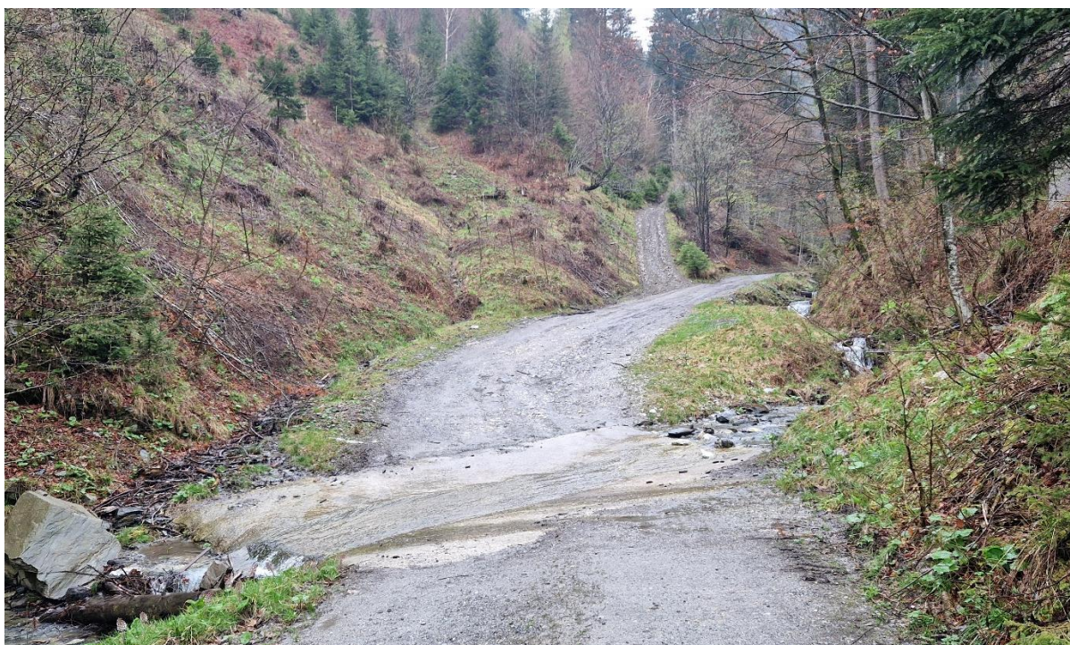
Slika 42: Utrjena mulda na gozdni cesti (Vilhar U.)
