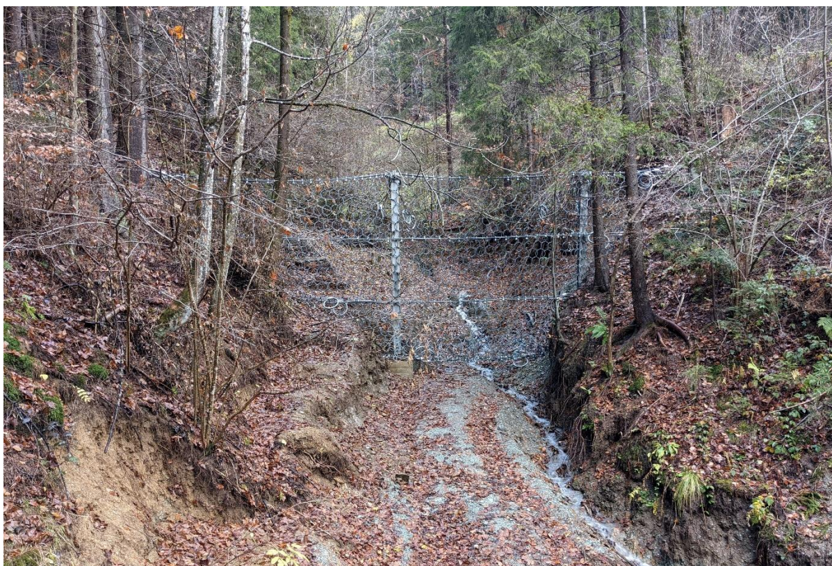
Slika 26: Mrežna hudourniška pregrada na območju Črne na Koroškem (Cej T.)
