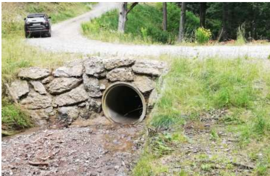
Slika 6: Večji cevni prepust na gozdni cesti
