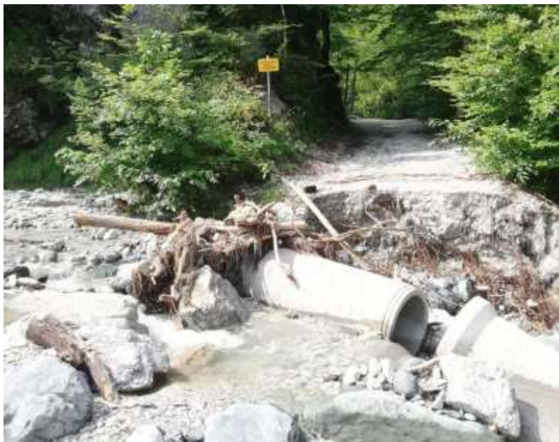
Slika 5: Cevni prepust, zamašen z lesnim plavjem, je botroval porušitvi odseka gozdne ceste (fotografija: Saražin J.)
