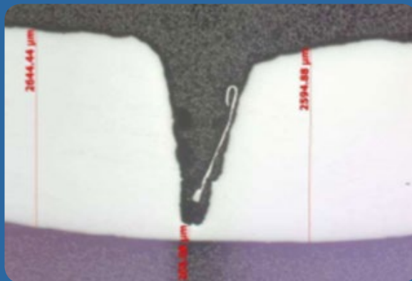
Močno poškodovano mesto na cevi za hladno vodo. Preostala debelina stene je 200 \mu\text{m} .
