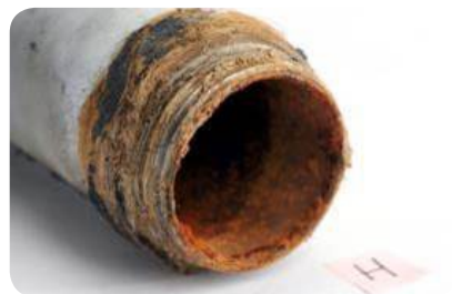
Primer korozijskih poškodb na pocinkani jekleni cevi za toplo vodo
