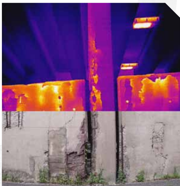
Primerjava termične in optične slike poškodovane konstrukcije
