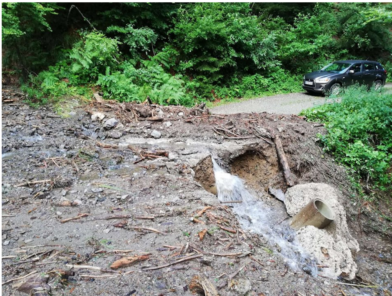
Slika 3: Nezdostno utrjeni iztoki in okolica cevnih prepustov so pogosto rezultirali v poškodovanju ali izpadu zadnjega cevne prepusta.
