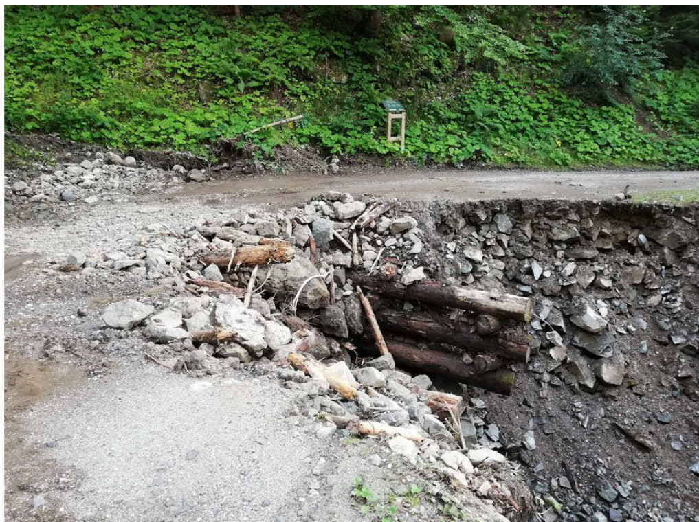
Slika 5: Zasilno vzpostavljena prevoznost prometnice za osebna in intervencijska vozila po tem, ko je drobirski tok odnesel lesen most. Gozdne prometnice so bile marsikje ključne za dostop interventnih služb, tako do kmetij, kakor tudi do naselij, kjer so bile javne prometnice neprevozne.
