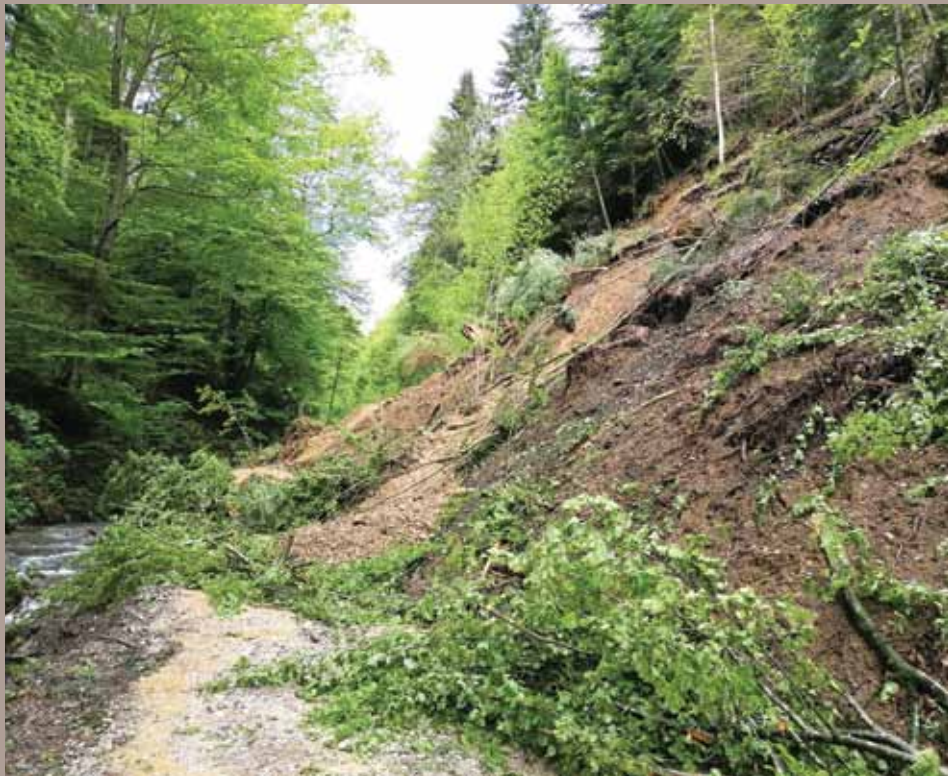
Zemljinski plazovi v gozdu so tako rekoč vedno povezani z vodo, pogosto pa ogrožajo tudi javno infrastrukturo (plaz Glažuta v Kozjem – julij 2023).
