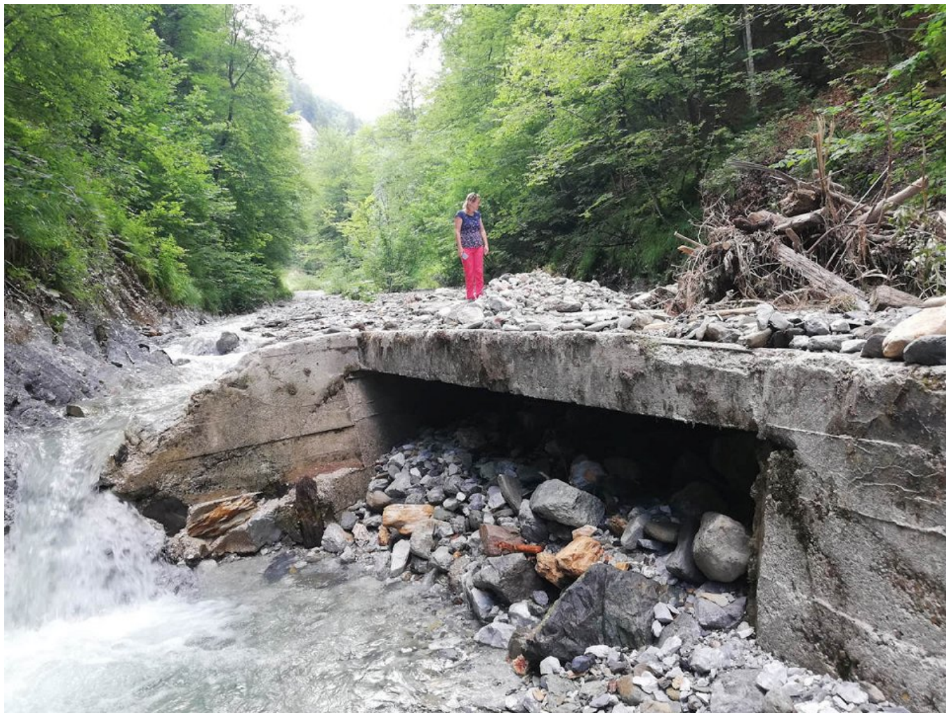
Slika 3: Po zamašitvi mostu je hudournik odnesel približno 100 m odsek gozdne ceste in popolnoma spremenil svojo strugo (Foto: Jaša Saražin)
