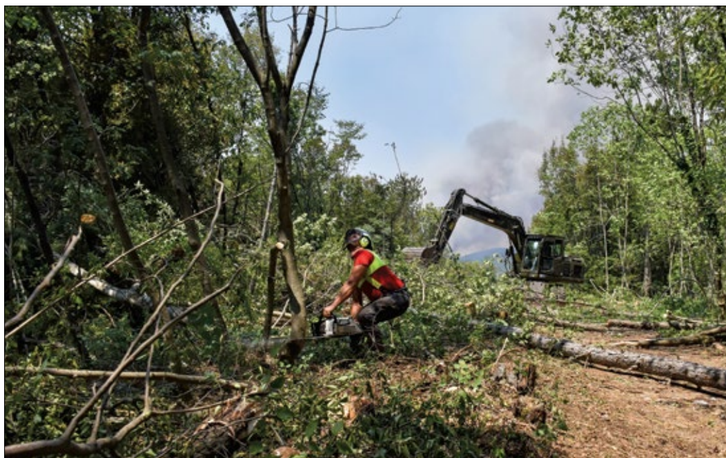
Slika 6: Dela na intervencijskih presekih so potekala ob pomoči gradbene mehanizacije Slovenske vojske (foto: B. Rantaša)
