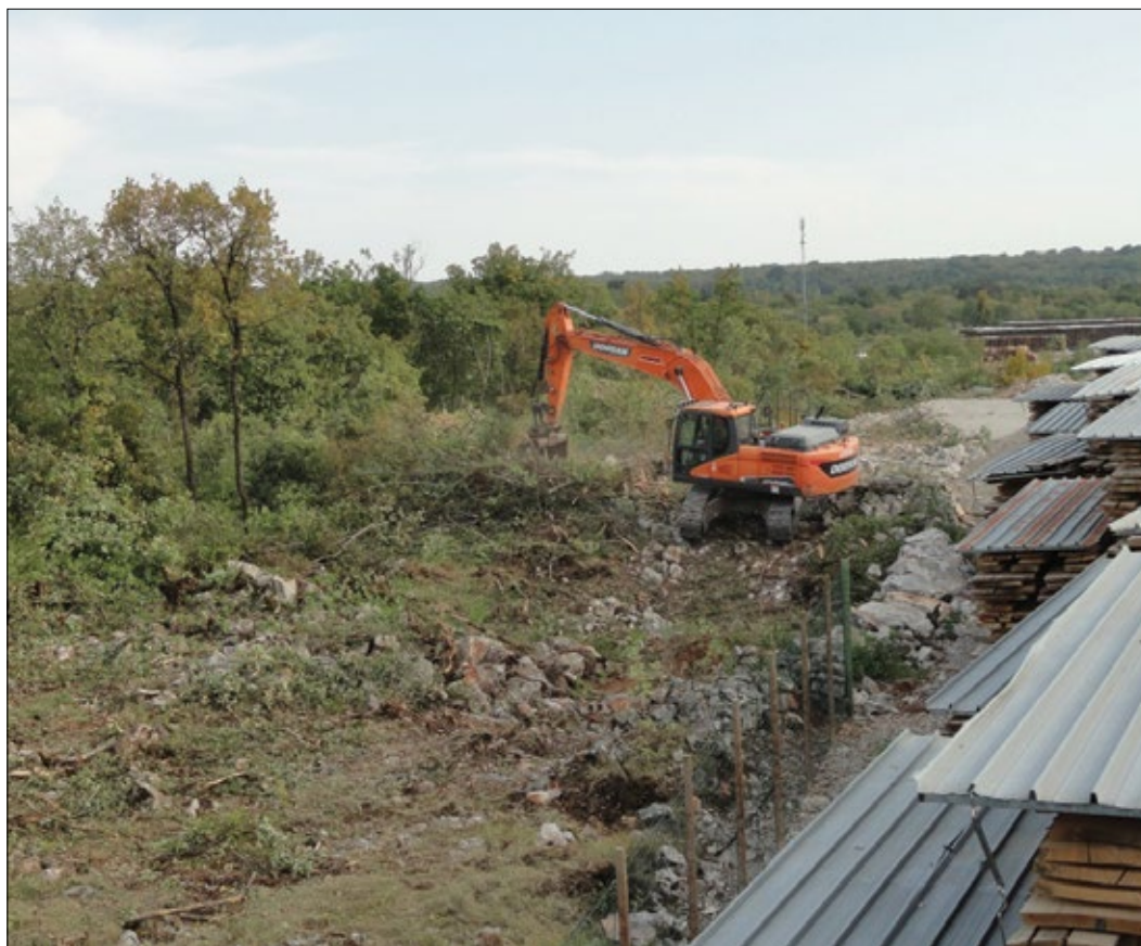
Slika 6: Interventna izdelava preseke z gradbeno mehanizacijo okoli podjetja Marušič, d. o. o., kjer je skladiščena velika količina bukovih desk (foto: J. Saražin).
