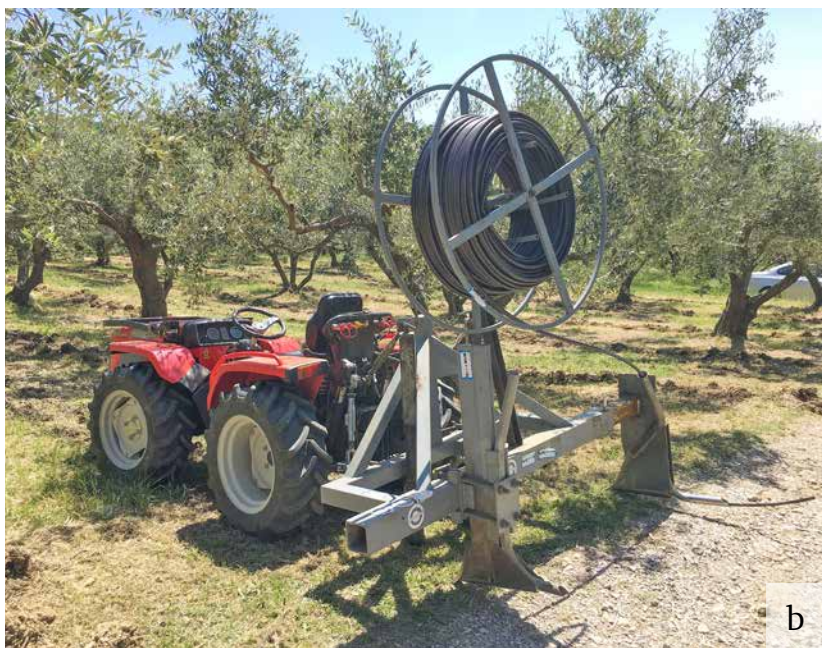
Slika 39: Poškodbe rastlin pri vgradnji cevi v tla (a), mehanizacija postavitev cevi v tla (b) in nepravilno odstranjen večji skelet (c).
