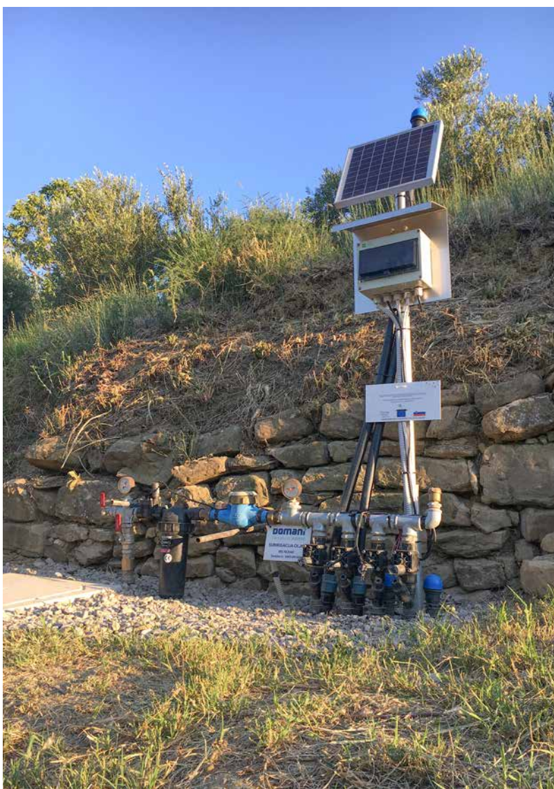
Slika 37: Elektromagnetni ventil, avtomatski krmilnik in dežemer.
