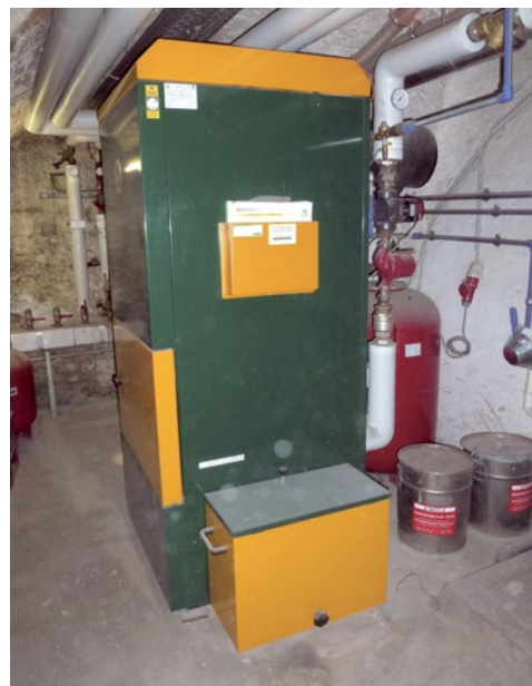
Sistem ogrevanja na pelete z močjo 99 kW, izvajalec: WDS Graz (podružnica družbe Energie Graz)
